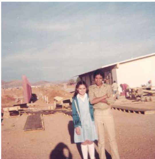
Construcción de aulas en la Escuela Secundaria Federal Número 7, s/f. Fuente: Sin dato.
